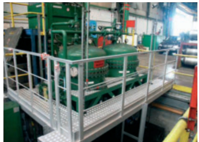
Plancher de travail périphérique pour assurer la maintenance des groupes de pression en toute sécurité.
